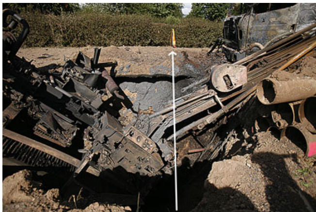
Zerstörte Maschine, die in Köln in Sichtweite des Markierungspfahls die Sauerstoffleitung in 4 Meter Tiefe anbohrte
